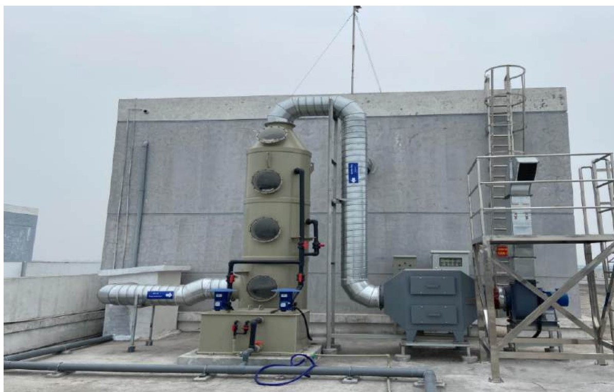
Hình 3.17. Hệ thống XLKT công đoạn sấy, rửa plasma, rửa bằng in, máy phân bản và hàn xưởng F1 công suất 4.500 m 3 /h
