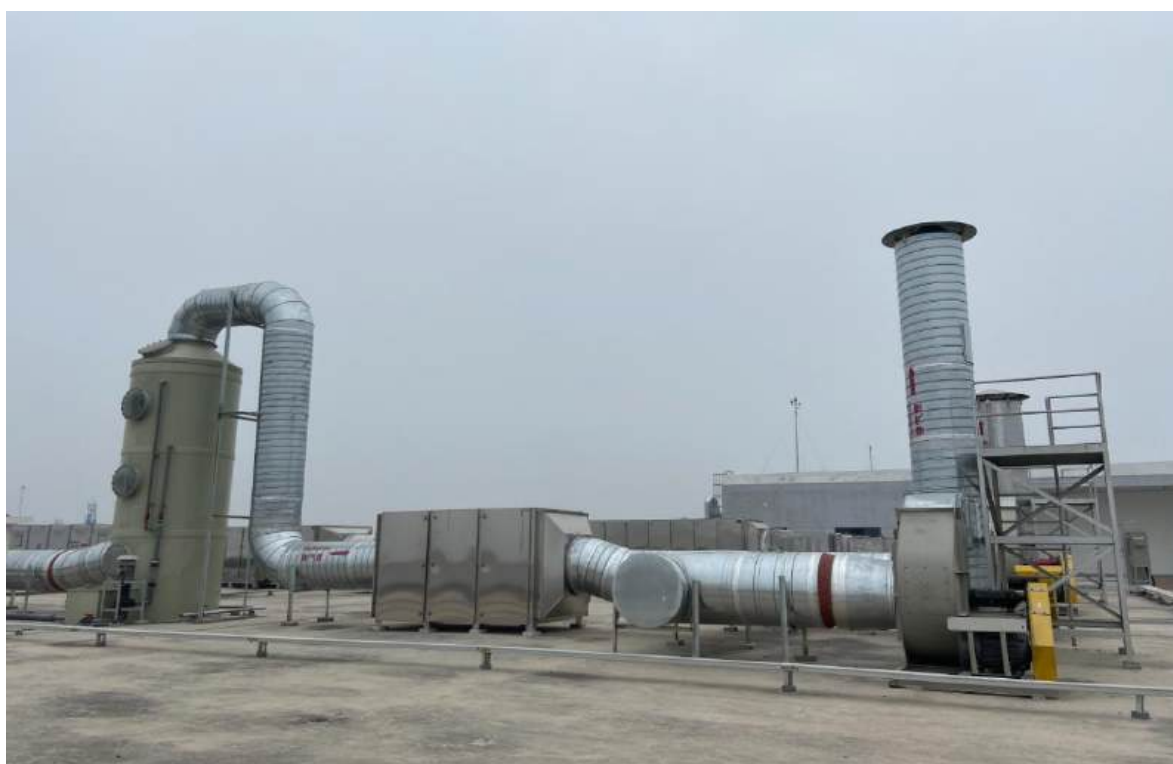
Hình 3.13. Hệ thống XLKT tại lò sấy, phòng in, máy khắc laser, phòng pha sơn và chứa sơn công suất 30.000 m 3 /giờ giai đoạn 1
