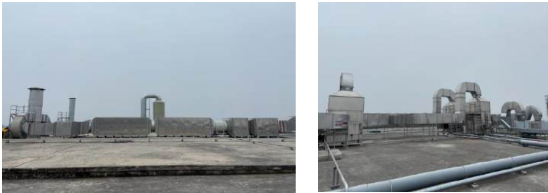
Hình 3.18. Hệ thống XLKT tại phòng cấp sơn, buồng phun sơn, buồng loại bỏ bụi, lò sấy UV xưởng F1 công suất 90.000m 3 /h
