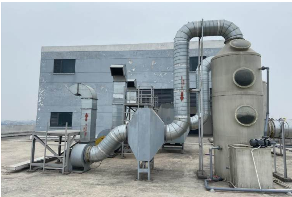
Hình 3.15. Hệ thống XLKT công đoạn rửa khuôn in xưởng F1 công suất 8.000 m 3 /h
