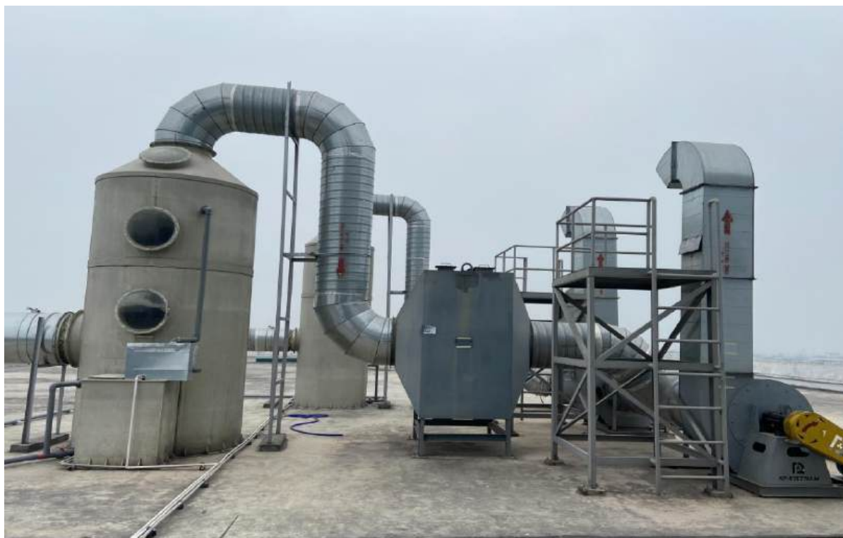
Hình 3.16. Hệ thống XLKT công đoạn in và sấy sau in F1 công suất 15.000m 3 /h
