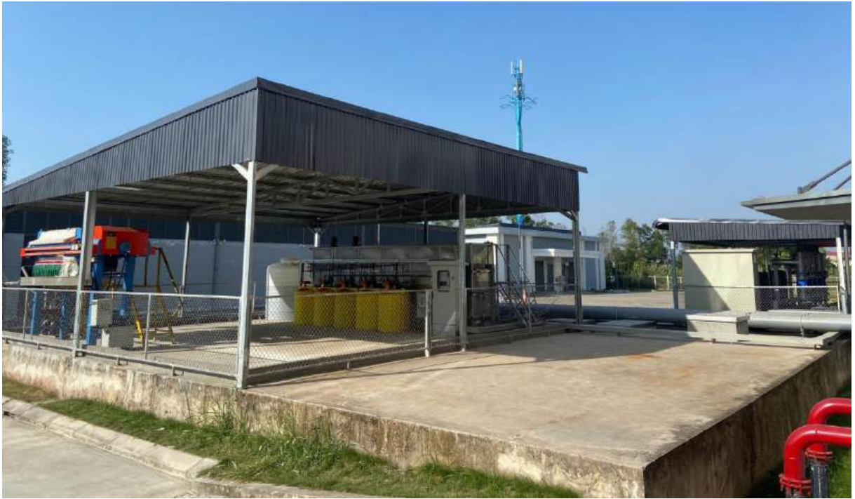
Hình 3.8. Hệ xử lý tuần hoàn nước thải 300 m³/ngày.đêm giai đoạn 1
