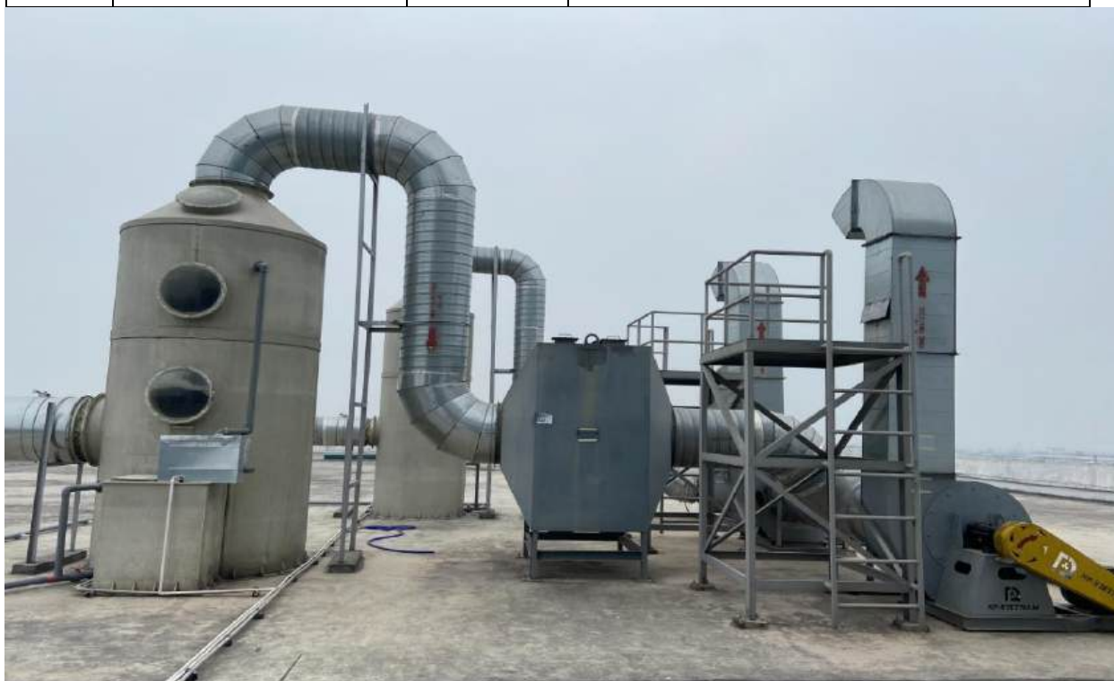
Hình 3.12. Hệ XLKT khu vực (phun sơn, lò sấy, máy rửa khung nhôm) xưởng F2 công suất 15.000m 3 /h
